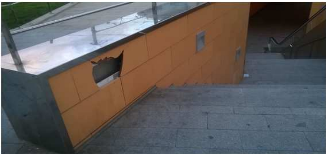
PLAZA DE LOS CARROS DE TARRAGONA, paso subterráneo que une el Puerto al resto de la Ciudad.
